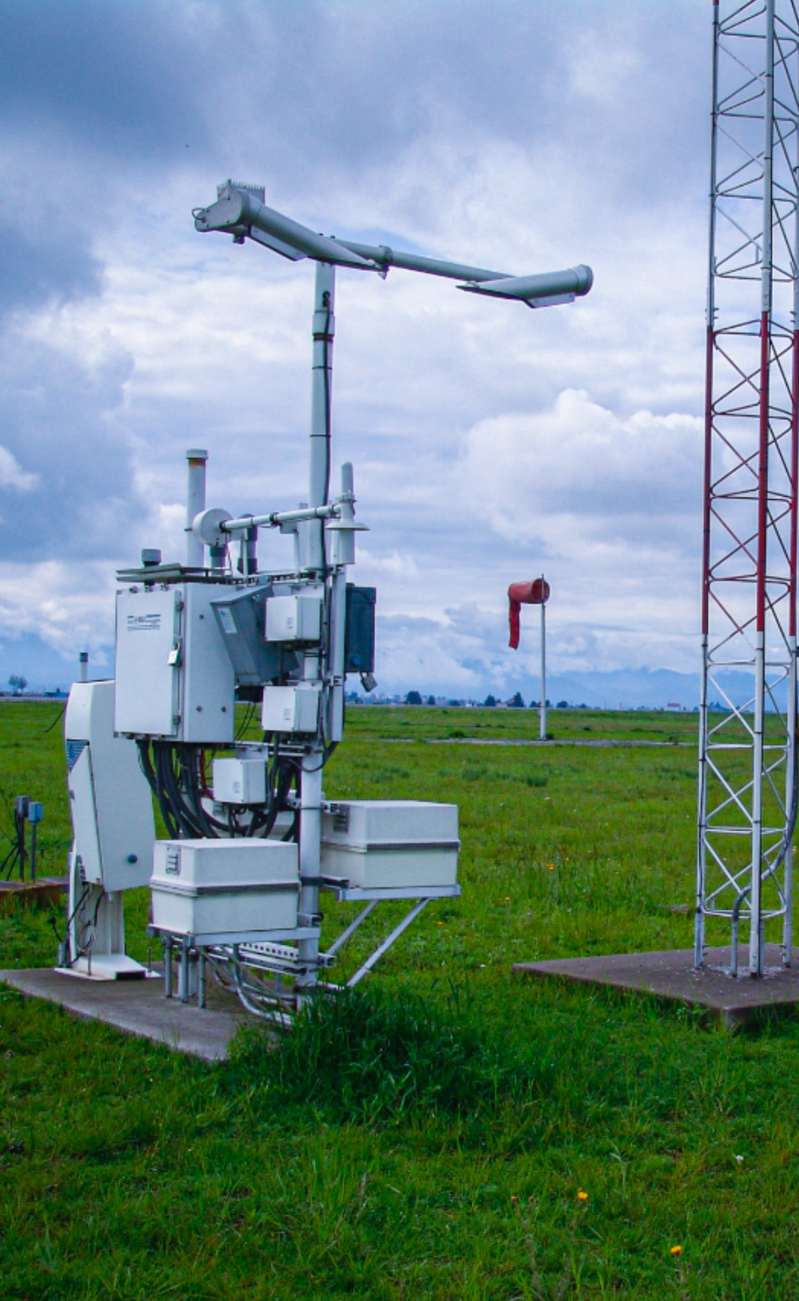
Antena de comunicaciones y Radioayudas
